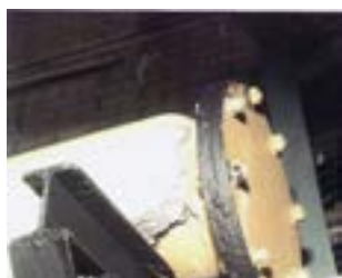
Asbestos pipe lagging
