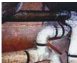
Asbestos pipe lagging
