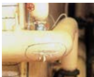
Asbestos pipe lagging
