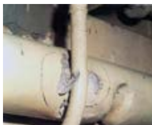
Asbestos pipe lagging
